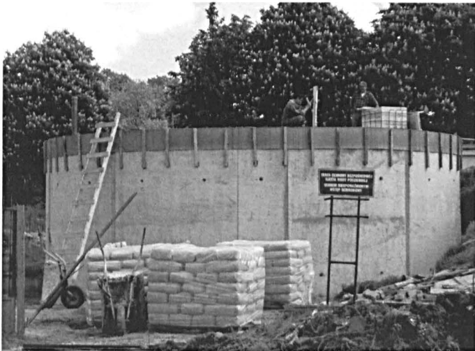
Stacja uzdatniania wody w Jabloniu
