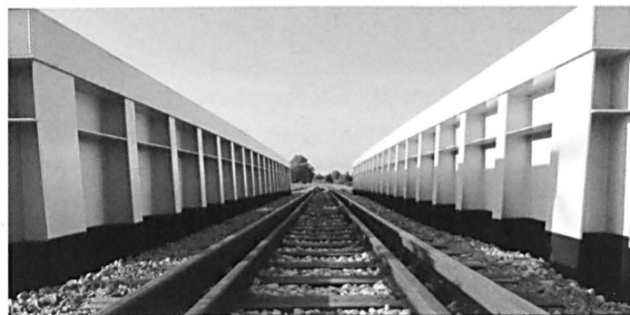
Nowy most na rzece Pivonii zbudowany już w ramach modernizacji szlaku kolejowego z Parczewa do Łukowa
