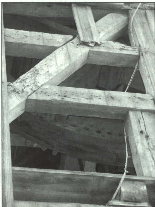
Fragment wnętrza widoczny przez braki w oszalowaniu, w głębi koło paleczne.
