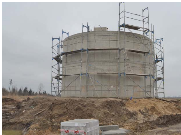
Zbiornik wody uzdatnionej o całkowitej pojemności V=347 \text{ m}^3 w Halasach
