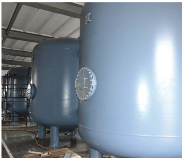
Filtry w budynku technologicznym
