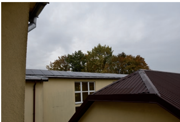
Instalacje fotowoltaiczne na budynku szkoły podstawowej w Rzeczycy
