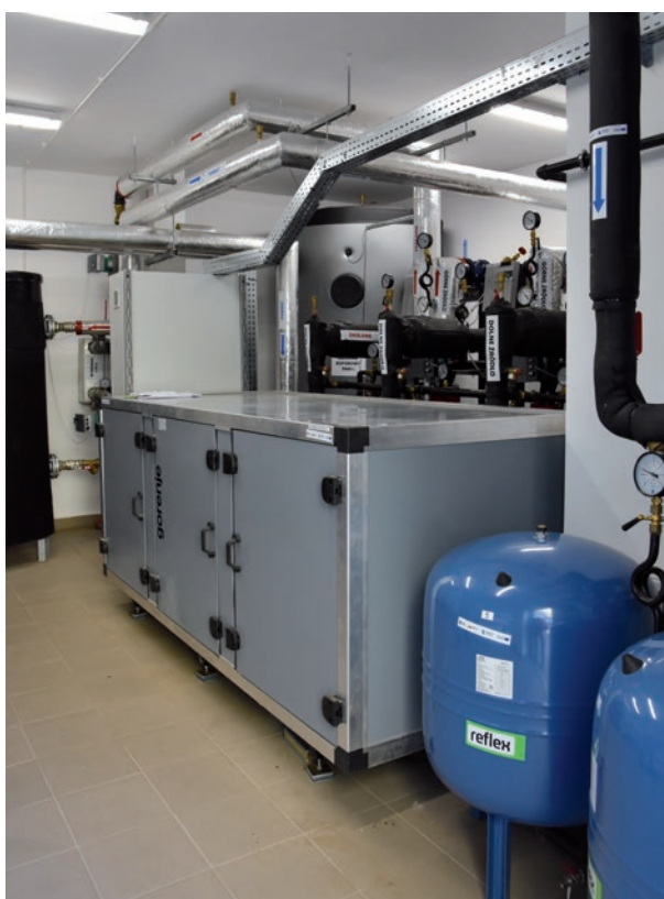
Armatura pompy ciepła w szkole podstawowej w Rogoźnicy
