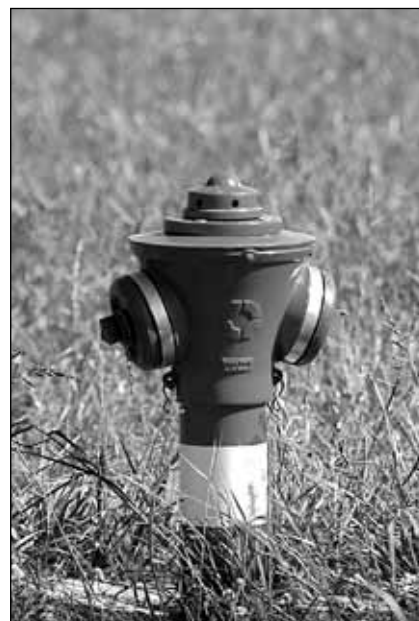
Hydrant z nowego wodociągu w gminie
