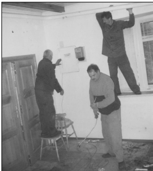
Fotografia 19. Montaż nowej instalacji grzewczo-sanitarnej w kościele garnizonowym. Źródło APK, t. III, b.p.
