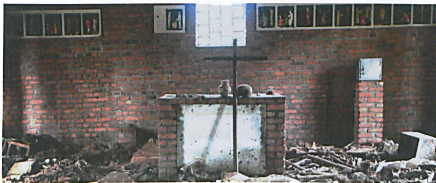
Foto nr 1. Zniszczony budynek kościoła katolickiego w Nigerii (ze zbiorów ks. dr Sławomira Byliny)
