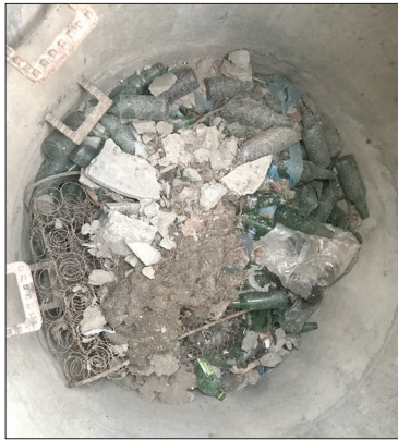
Nawet takie śmieci trafiają do sieci kanalizacyjnej...
