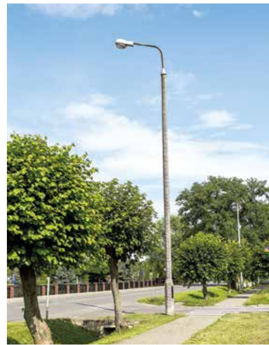
Zarząd Województwa Lubelskiego zatwierdził do dofinansowania projekt budowy, modernizacji oraz wdrożenia inteligentnego oświetlenia w technologii LED w Gminie Leśna
