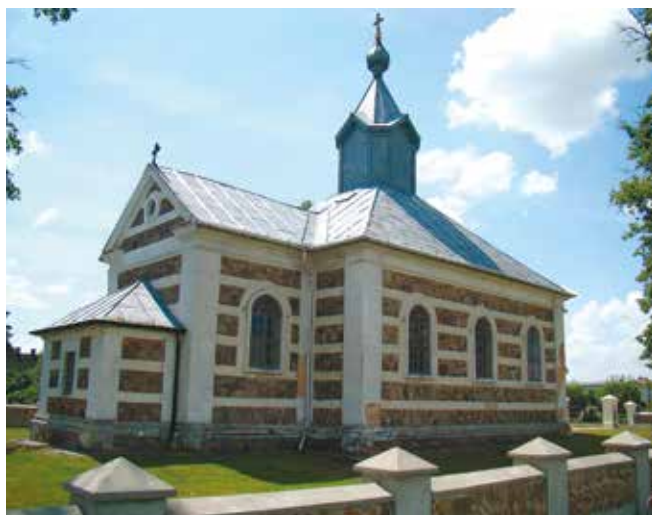
Nieodzowny jest kapitalny remont tej pięknej świątyni. Jak zapowiada biskup Abel, czynione są intensywne zabiegi, aby pozyskać zewnętrzne środki europejskie na jej rewitalizację
