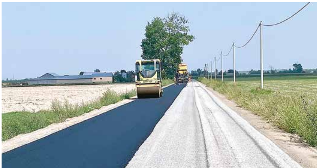
W tym roku wybudowany został długi, ponad 2-kilometrowy odcinek drogi, łączący sołectwa Witulin i Witulin-Kolonie
