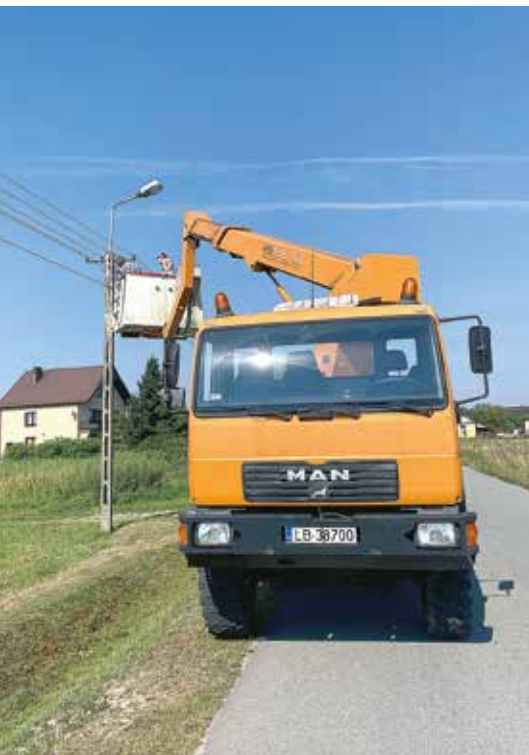
Trwa wymiana oświetlenia ulicznego w gminie z sodowego na energooszczędne ledowe. Na zdjęciu montaż nowych lamp w Ludwinowie
