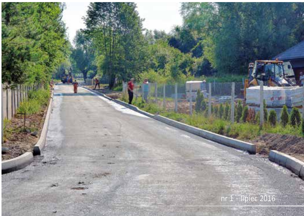
Ta inwestycja ułatwi życie mieszkańcom południowej części Janowa Podlaskiego. Na zdjęciu budowa ulicy Kapielowej
