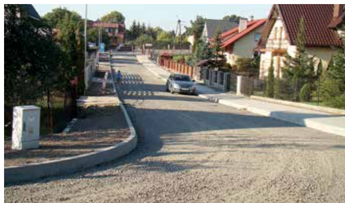
Trwa budowa czterech ulic w Janowie Podlaskim. Na zdjęciu skrzyżowanie ulic Chrobrego z Nadrzeczną
