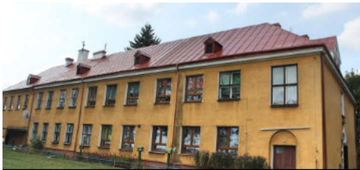
Budynek Szkoły Podstawowej w Huszcy czeka wymiana pokrycia dachowego
