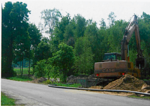
Trojanów - sieć kanalizacyjna
