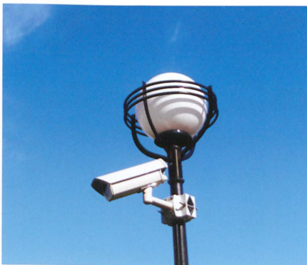
Monitoring całego obiektu, zainstalowano 10 kamer
