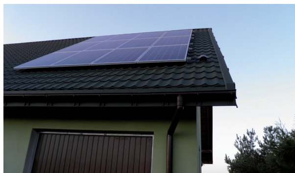
Instalacja fotowoltaiczna na budynku jednorodzinnym
