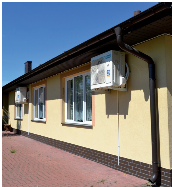
Klimatyzacja w świetlicy wiejskiej w Rogoźnicy
